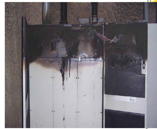
負載過大引起電線走火
